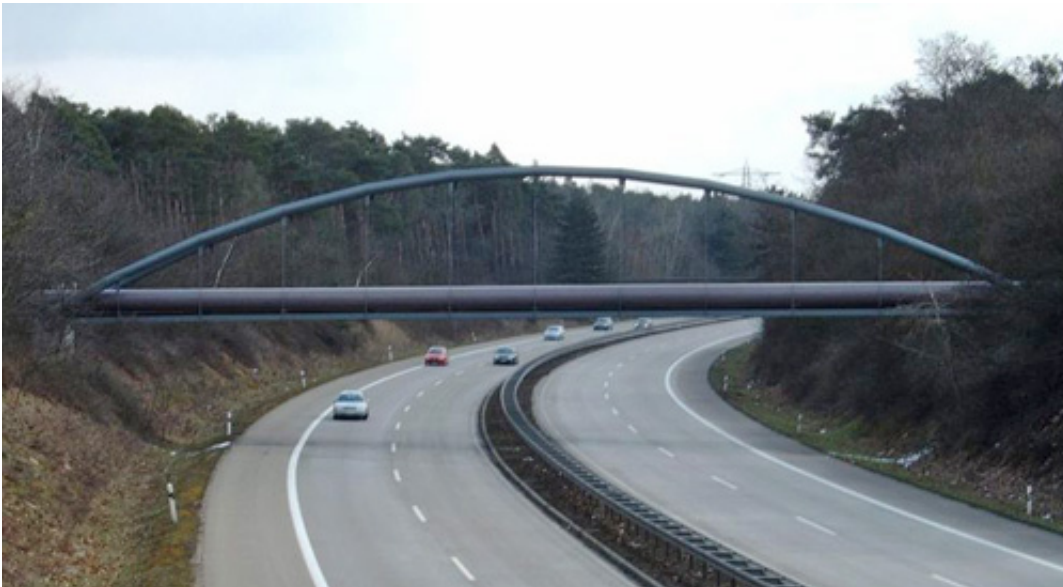
Bild 6: Oberirdische Fernwärmeleitungen über die B36 in Mannheim.
