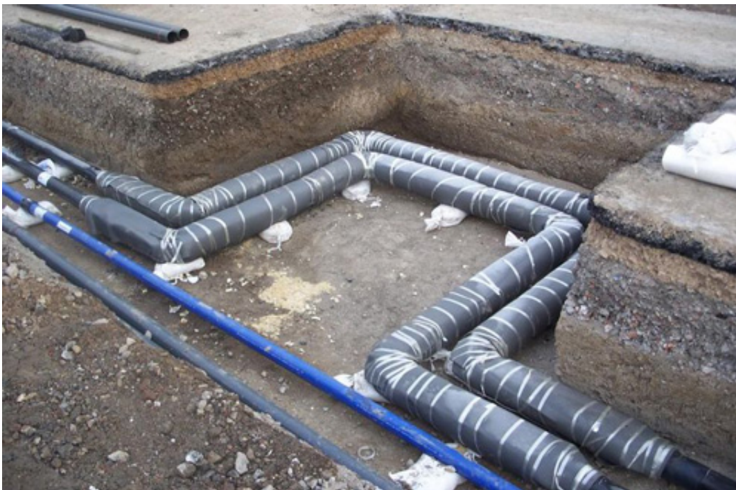
Bild 3: Erdverlegte Fernwärmeleitungen mit Dehnungsbogen.
