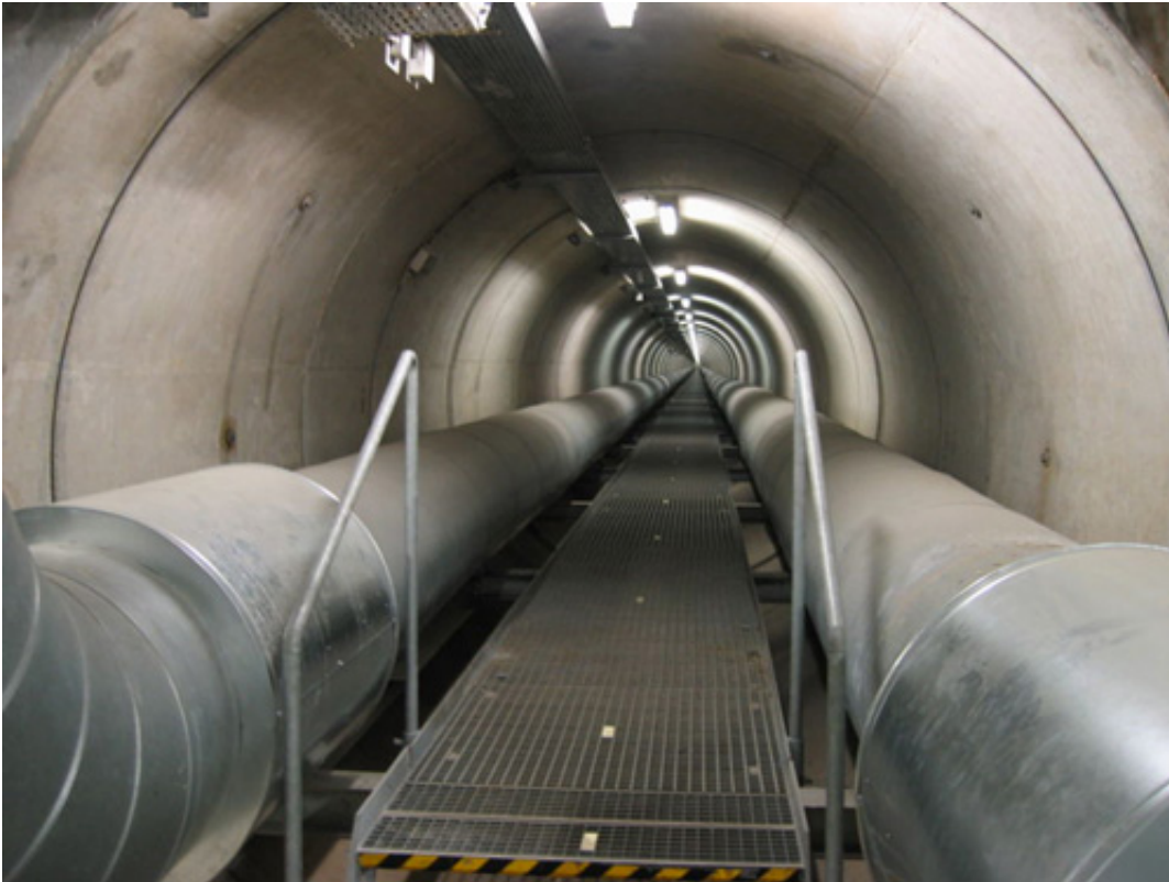
Bild 4: Fernwärmeleitungen in einem Tunnel unter dem Rhein
